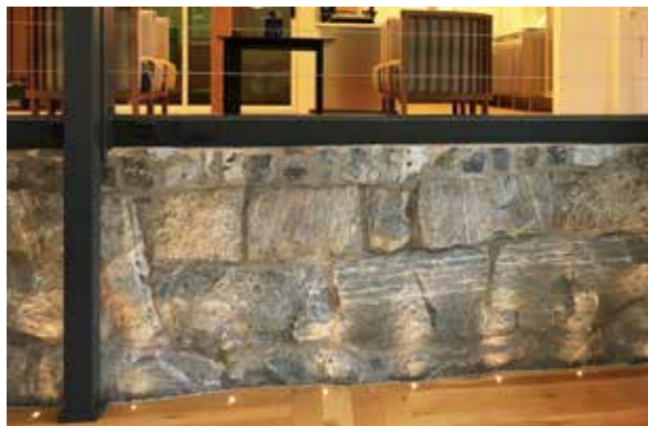
Stensocket vid nivåskillnad
